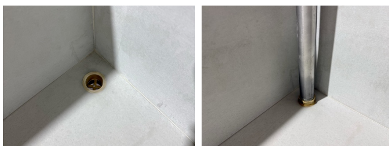
Messing-Abflüsse können mit der Zeit oxidieren. Das Ablaufrohr ist aus Edelstahl gefertigt.
